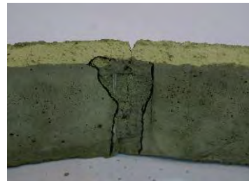
(c) 崩壊部詳細(内周面)
