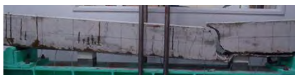
図 1.1.49 BFRP シート剥離の様子 (BF-H)
