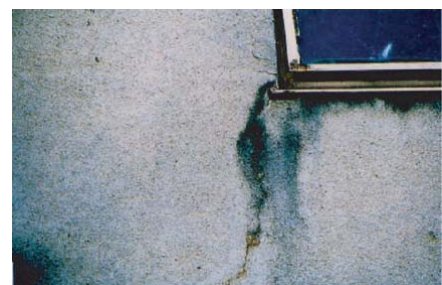
写真 2.2 乾燥収縮によるひび割れ
