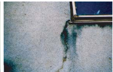
乾燥収縮によるひび割れ
