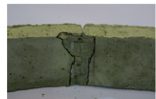
(c) 崩壊部詳細(内周面)
